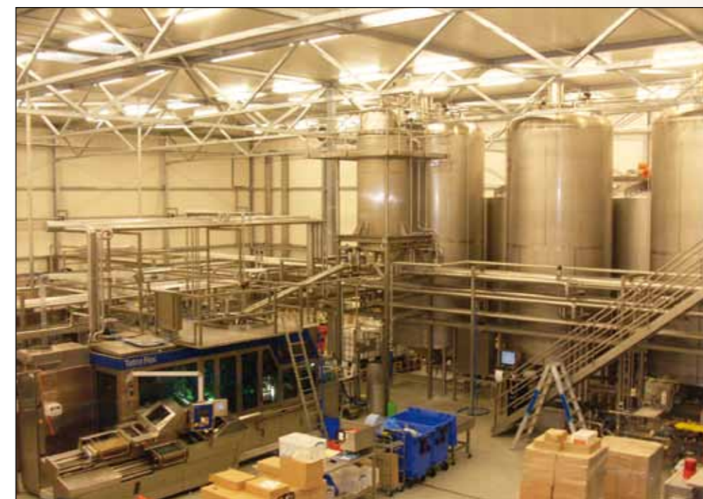
Op de voorgrond de afvalafdeling die wordt bevoorradt uit de tanks op de achtergrond.
